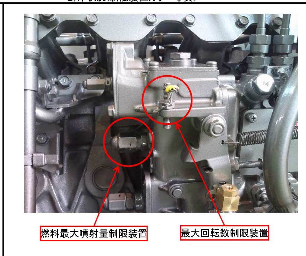
封印状況(制限装置カラー写真)
