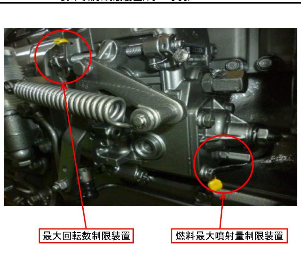
封印状況(制限装置カラー写真)
