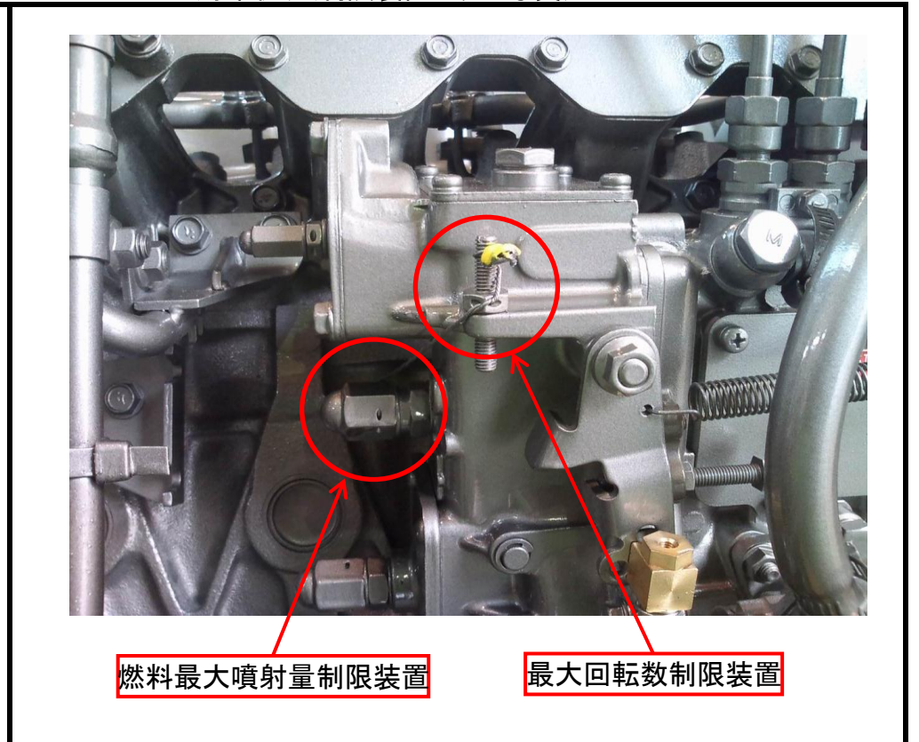
封印状況(制限装置カラー写真)
