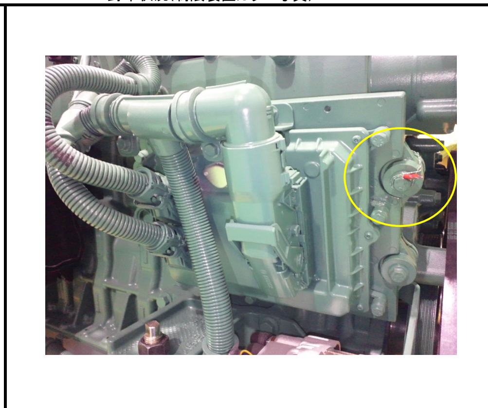
封印状況(制限装置カラー写真)
