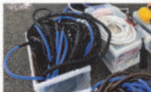
給電ケーブル
