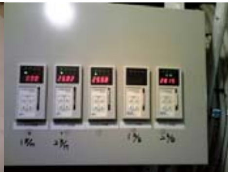
写真4 電力モニターと データ通信試験
