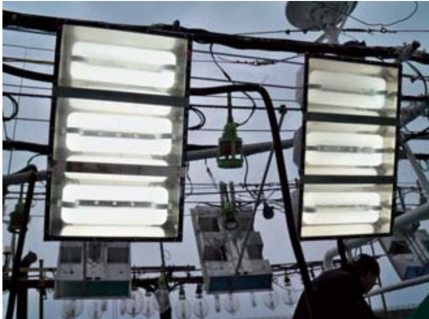
「写真 3：反射板を付けた箱形筐体」
