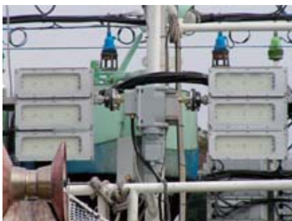
写真 5 ローテーターの設置状態
