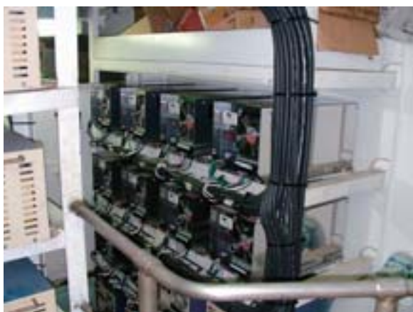
写真 3 LED 電源装置の設置状態
