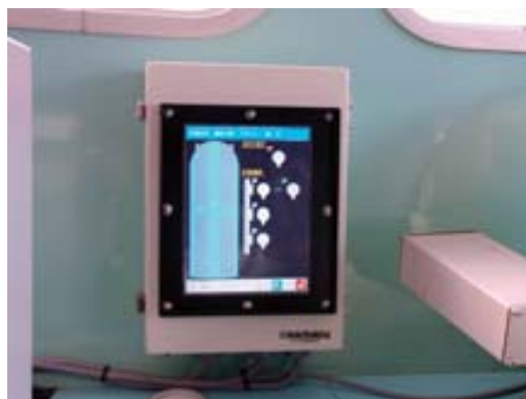
写真 4 LED 漁灯操作盤の設置状態
