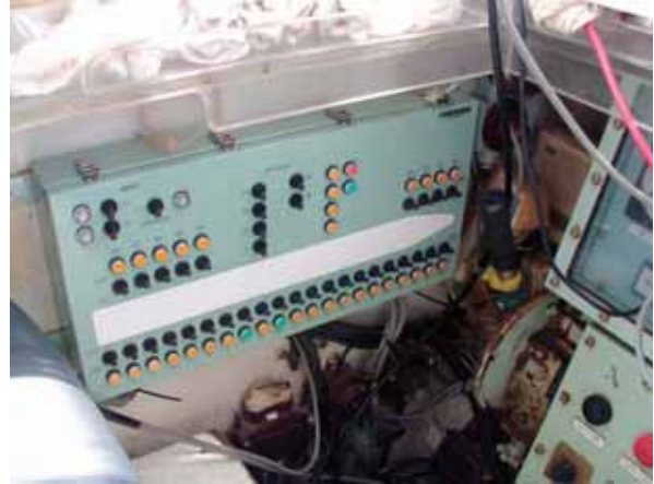
写真9 点灯・消灯操作盤
