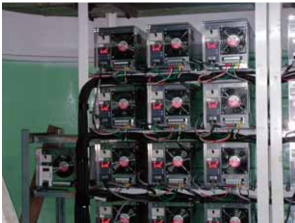
写真10 LED電源装置
