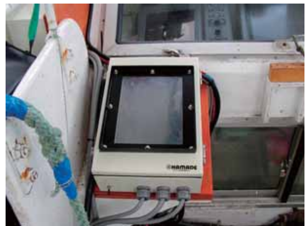
写真7 LED漁灯操作盤
