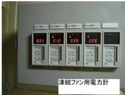
写真9 凍結ファン用電力量計
