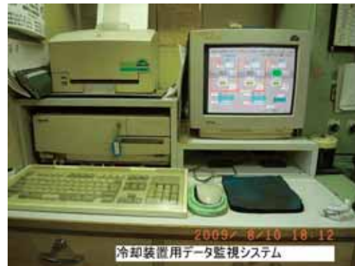
写真13 監視制御システム
