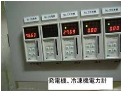
写真10 発電機、冷凍機電力量計
