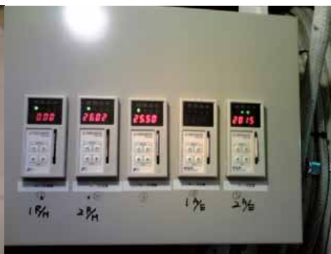
写真4 電力モニターとデータ通信試験
