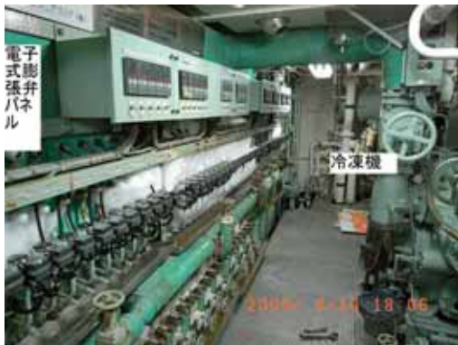
写真12 冷凍機、ヘッダー
