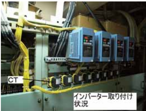
写真8 インバーター取付状況
