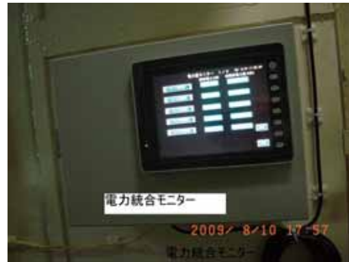
写真11 電力統合モニター
