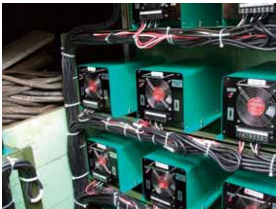
安定器設置状況
