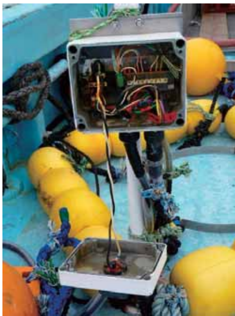
写真3 ケーブル接続ターミナ
