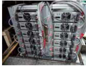
図8 LED灯用電源装置
