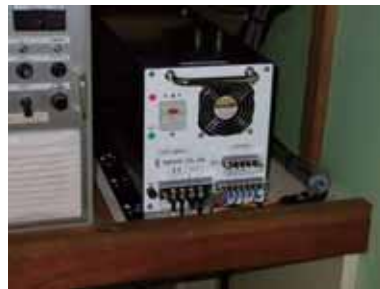
LED 水中灯電源装置
