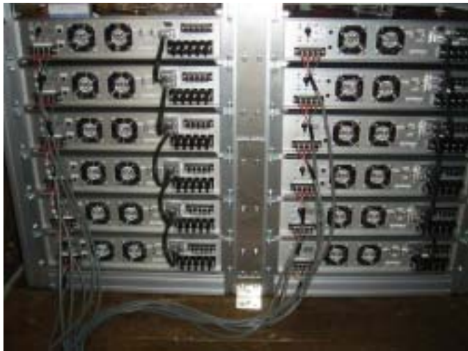
図 8 技術導入後 電源装置
